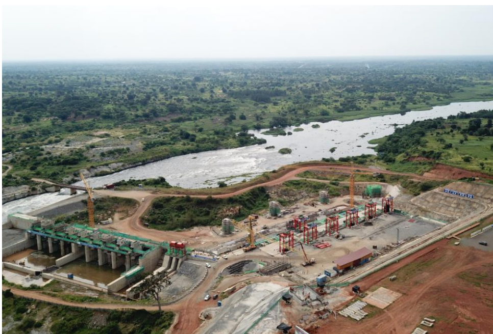
卡鲁玛水电站
