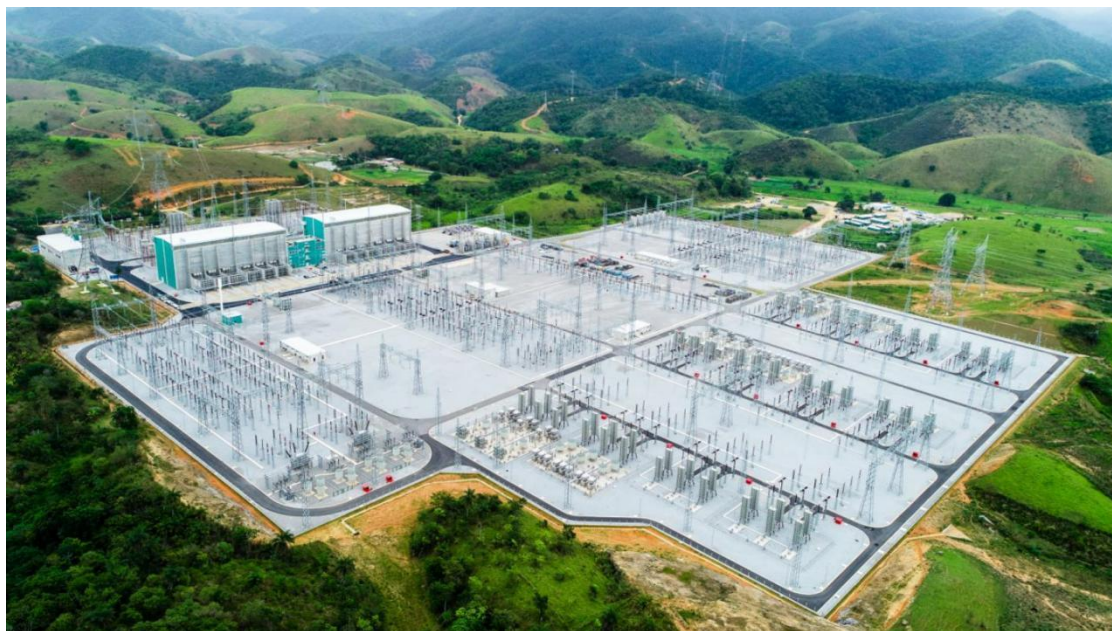
国家电网公司巴西美丽山项目里约换流站
